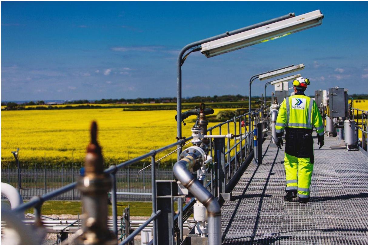
Foto: 21 Gassco | Haakon Nordvik : Langeled mottaksterminal, Easington
