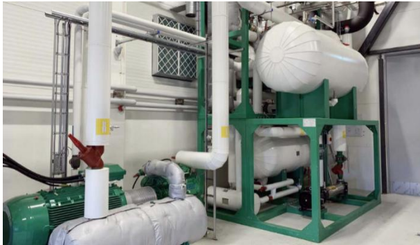
Figur V16. Det nye meieriet til Tine Bergen ble satt i drift i 2018, og utnytter lavtemp. overskuddsvarme. Foto: Bjarne Horntvedt Hybrid Energy AS Bilde: HighEFF Sluttrapport.
