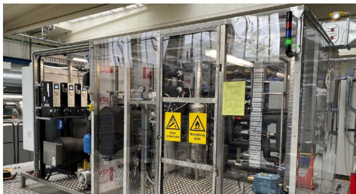
Figur V14. Ny varmeveksler test rig ved SINTEFs og NTNUs termiske lab for utprøving av ny varmeveksler teknologi: Bilde: SINTEF: HighEFF Sluttrapport
