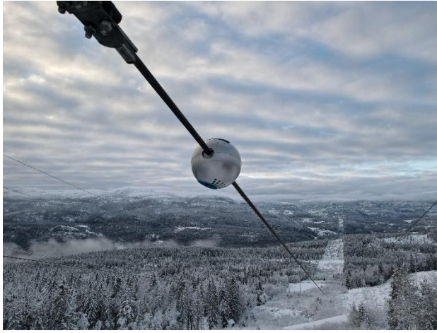
Figur V21. Heimdall Power sin Neuron for dynamisk drift av kraftledninger. Bilde: Heimdallpower
