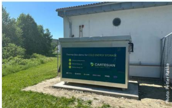
Figur V17. HighEFF sitt arbeid på termisk energilagring førte til installasjon av denne termoboksen hos REMA1000 supermarkedet i Mjøndalen. Foto: Petter Røkke. Bilde: HighEFF Sluttrapport.
