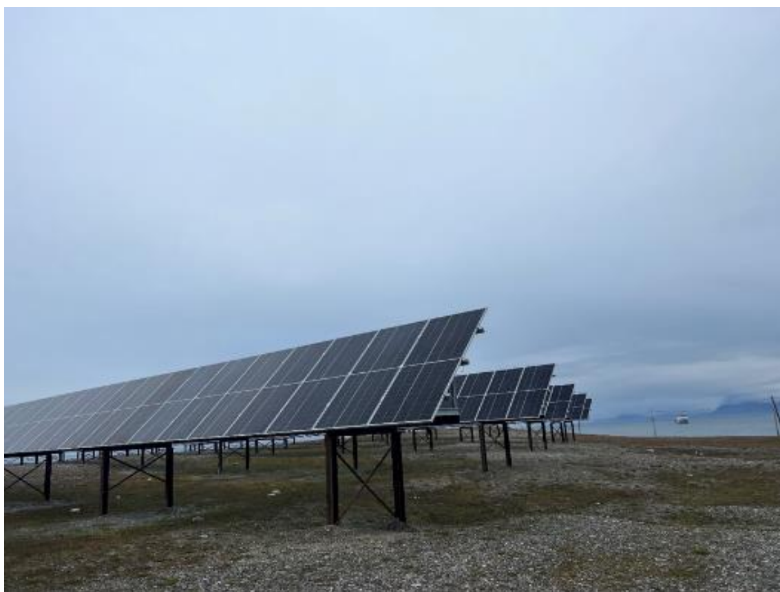
Isfjord Radio | Hybrid mikronett basert på solceller, vindkraft og energilagring | August 2023| Foto: L.Mostue
